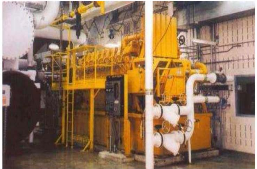
Figura 3.3.1 – Impianto di cogenerazione per la produzione combinata di elettricità e calore
